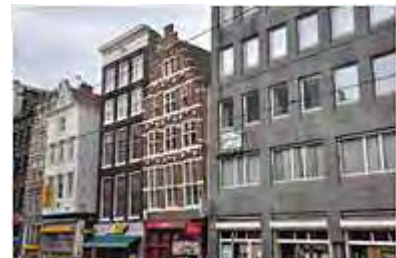
この建物写真中央の左の建物が前方へ傾いている。
