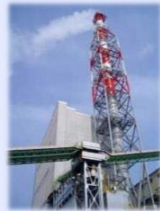
※RPF専用ボイラー(苫小牧工場6号ボイラー)
